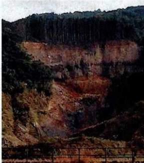
2015年に土石流が発生した鹿児島県鹿屋市の現場。火山噴出物が堆積した地域は、大雨による土砂災害のリスクが高い
