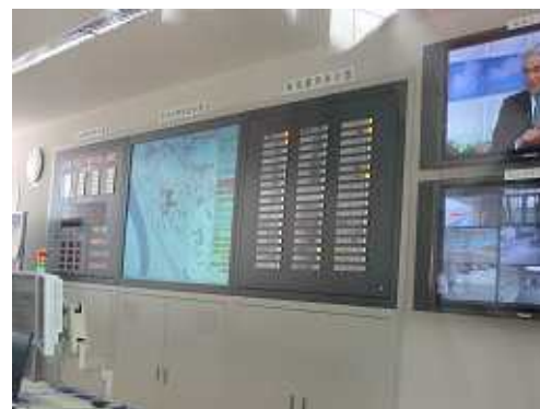
司令室壁面には各種ディスプレイが配置されています。ハイテク指令室でした。
