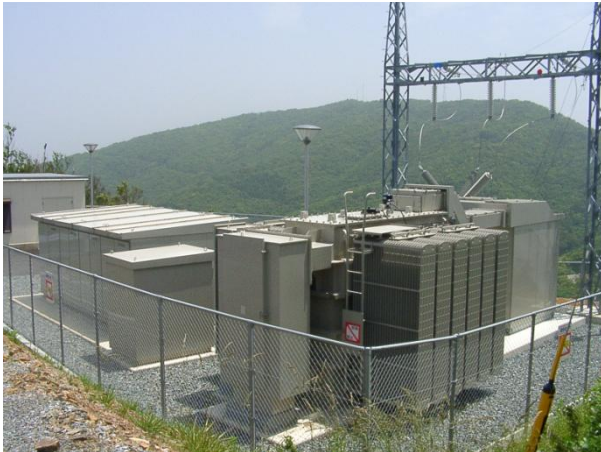
集電・変電設備
