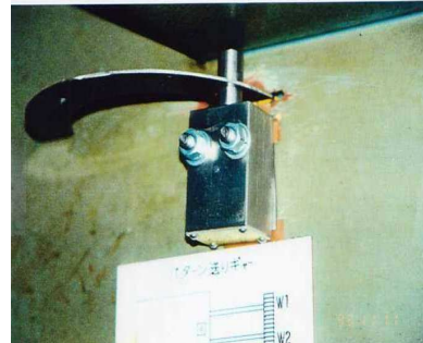
写真 3 延伸機パネル内部(キーボルトインタロック施錠状態)(図 1 ③の内部)
