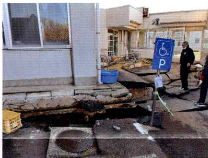
建物の基礎部分の陥没
