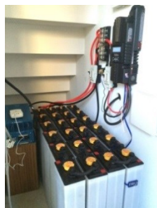
▲オフグリッドを支える蓄電池
