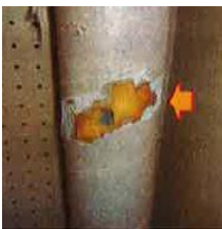
劣化、損傷したアスベスト含有保温材
