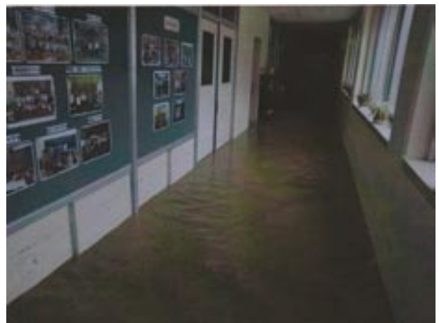
安浦小学校図書室前の廊下水没
